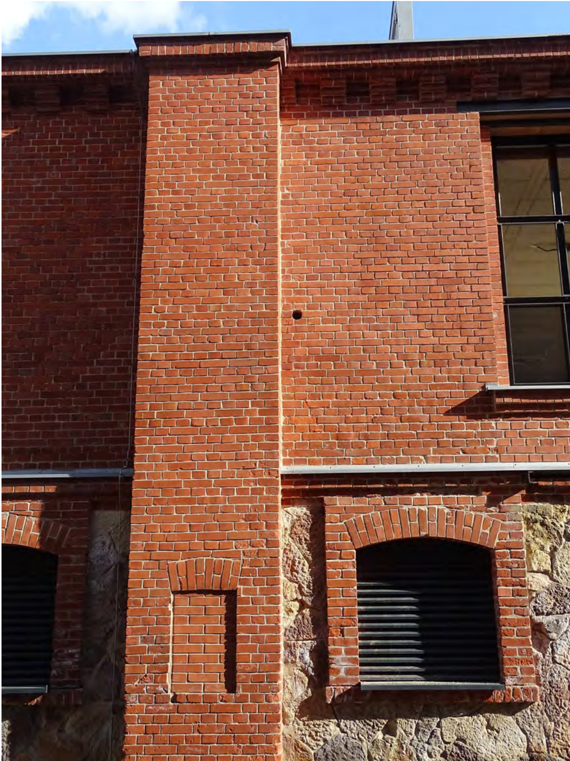
Nordwestgiebel der Kita mit Bohrung, die vermutlich Nistplatz des Hausrotschwanzes ist
