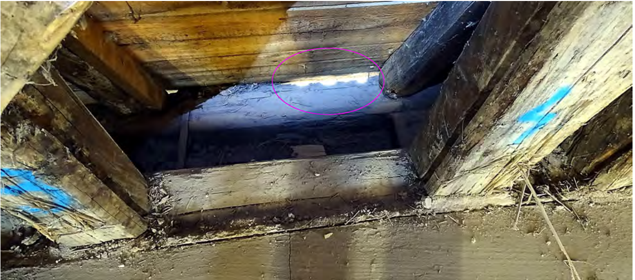
Bild 15: Spalten im Traufbereich des Daches vom Altbau
