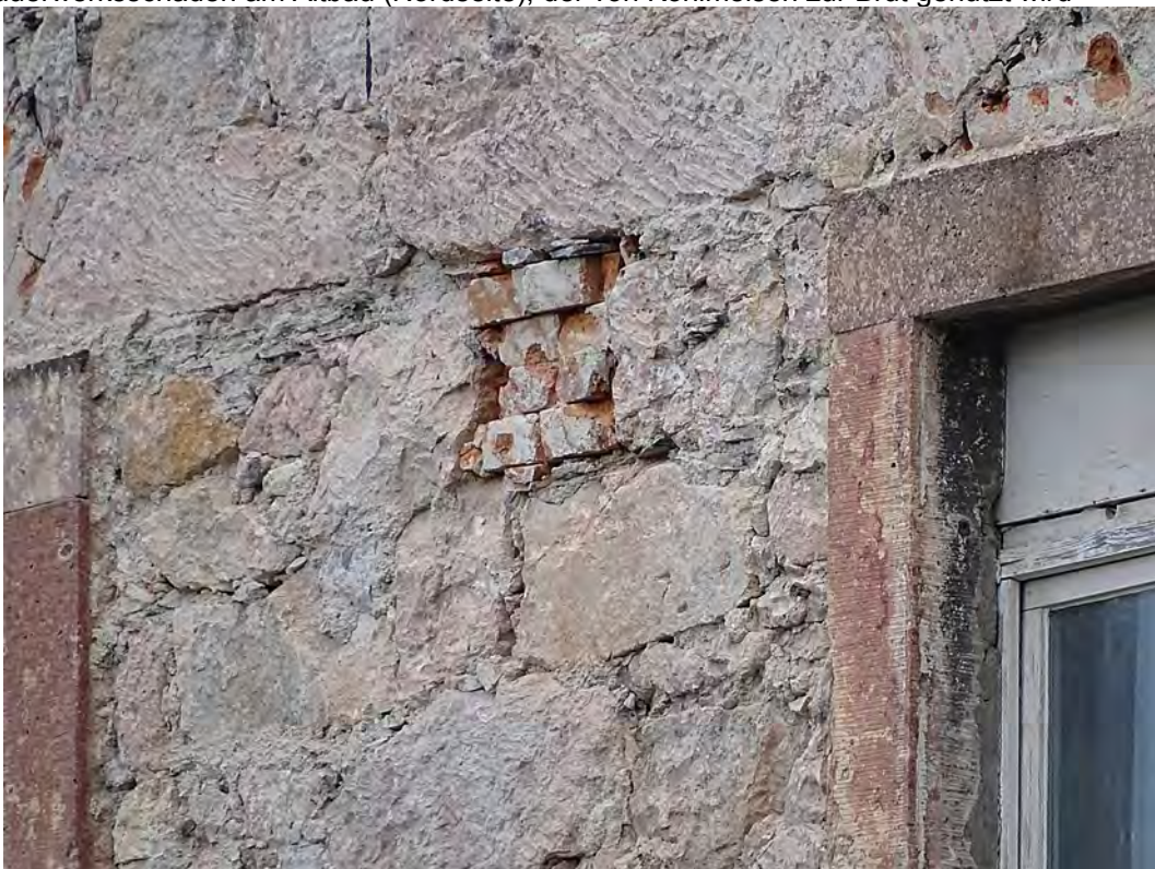
Bild 7: kleine Öffnung in der Mauer des Altbau, die von der Blaumeise zur Brut genutzt wird
