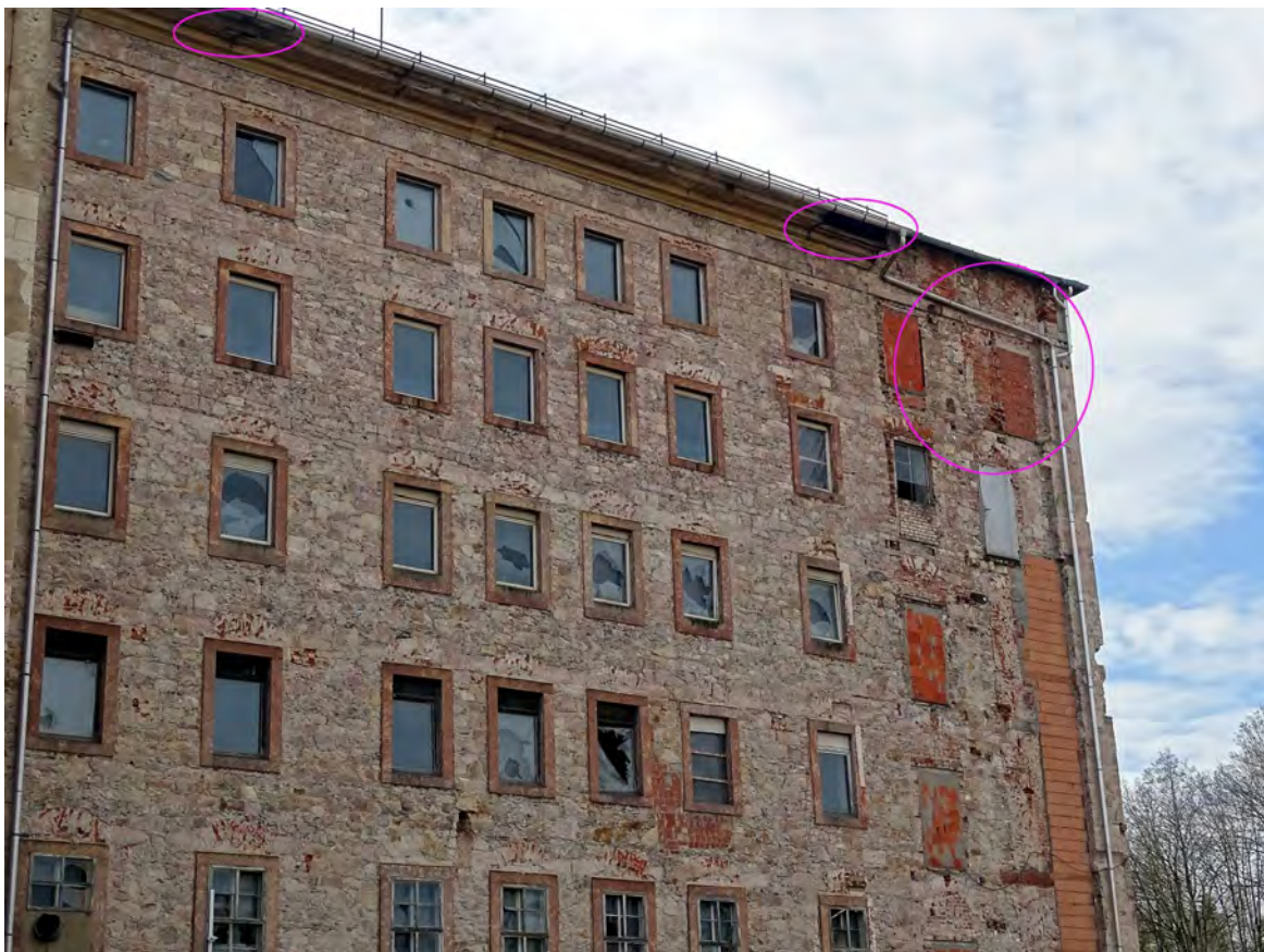
Bild 7: Hofansicht des Altbaues 1826, Mauerwerksschäden im Abrissbereich & im Traufbereich
