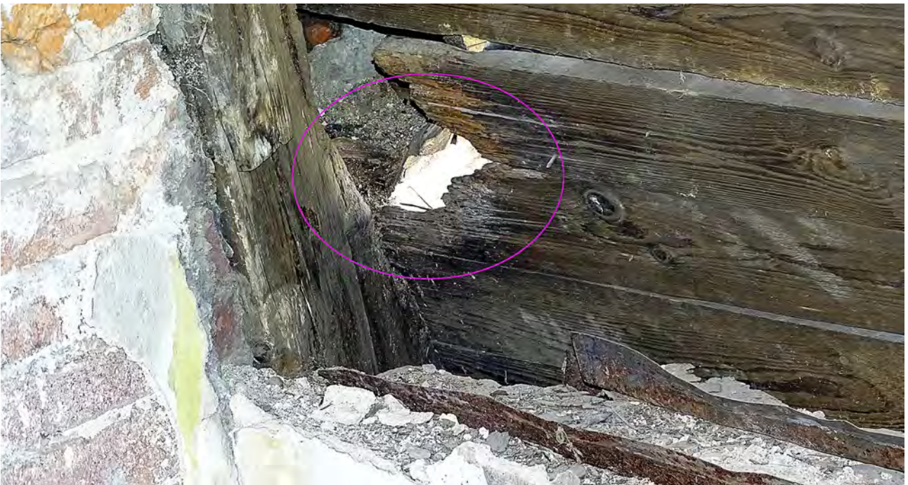
Bild 16: Schadstelle am Dach im Altbau
