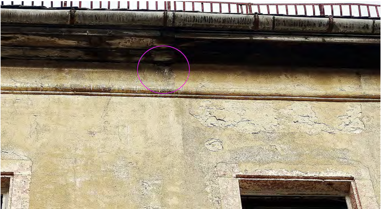
Bild 22: Spalt mit Vogelkottflecken im Traufbereich der Südfassade des Oederaner Baues
