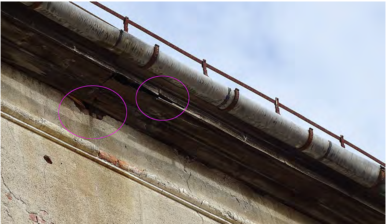
Bild 23: Schäden im Traufbereich der Südfassade des Oederaner Baues
