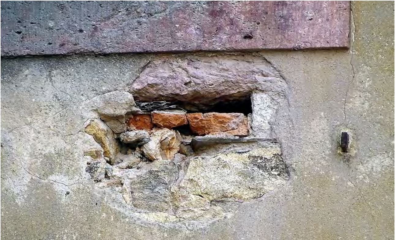
Bild 6: Nische in der Hoffassade des Altbaues 1809, die durch Mauerwerksschaden entstanden ist
