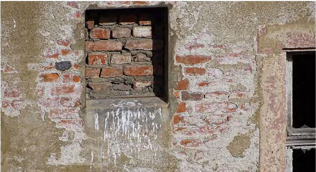
Bild 21: obere Nische an der Südfassade des Oederaner Baues mit Vogelkotflecken
