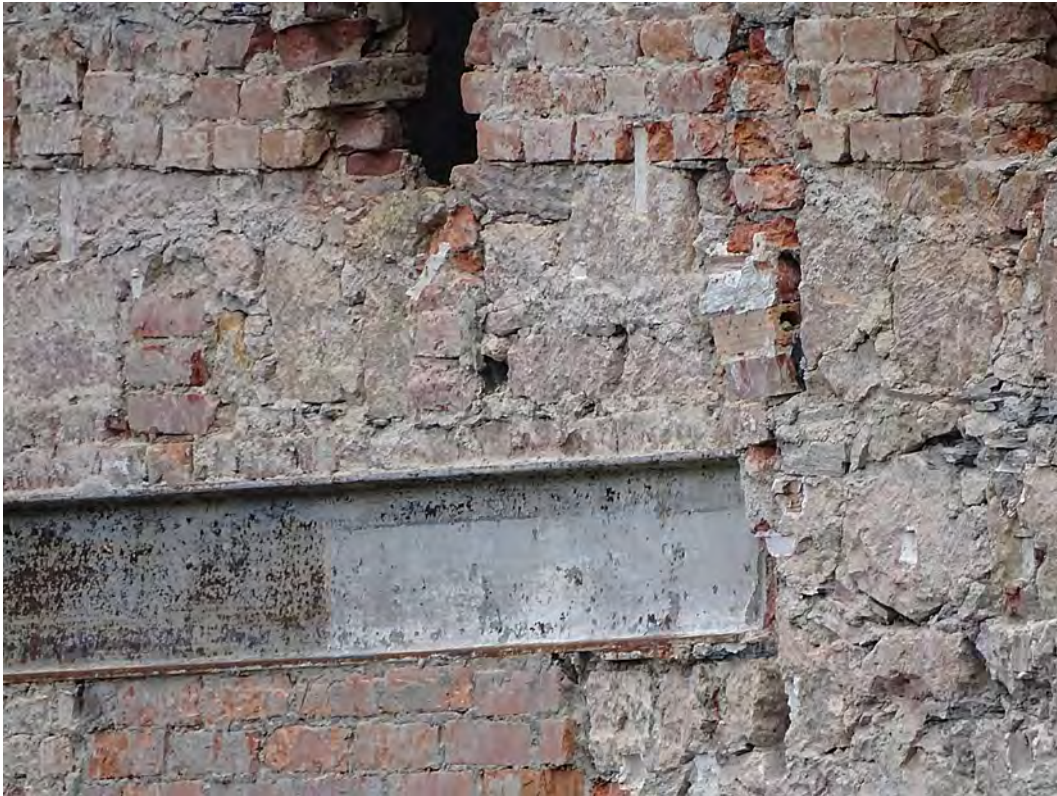
Bild 6: Mauerwerksschaden am Altbau (Nordseite), der von Kohlmeisen zur Brut genutzt wird
