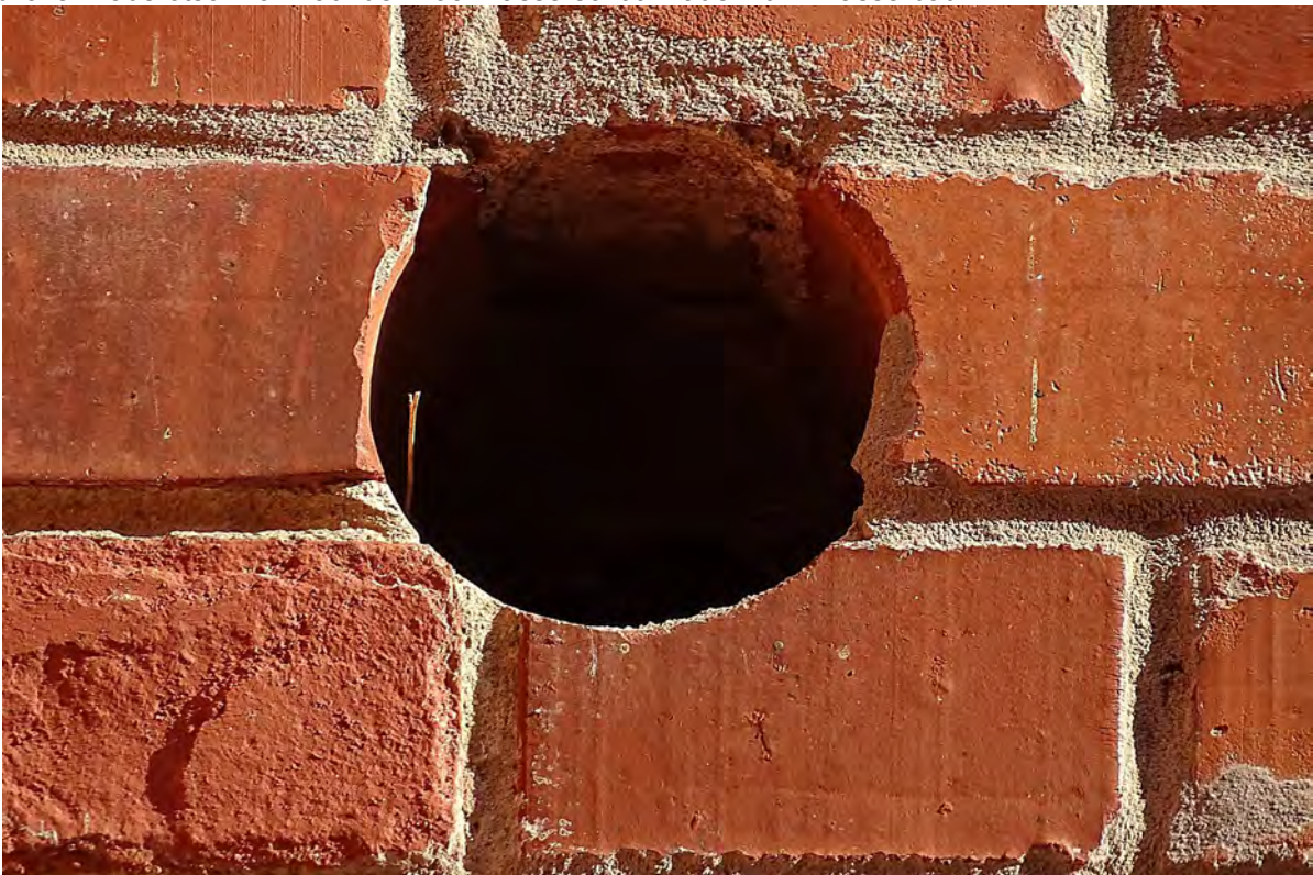
vermutlicher Nistplatz des Hausrotschwanzes in der Fassade am Nordwestgiebel der Kita
