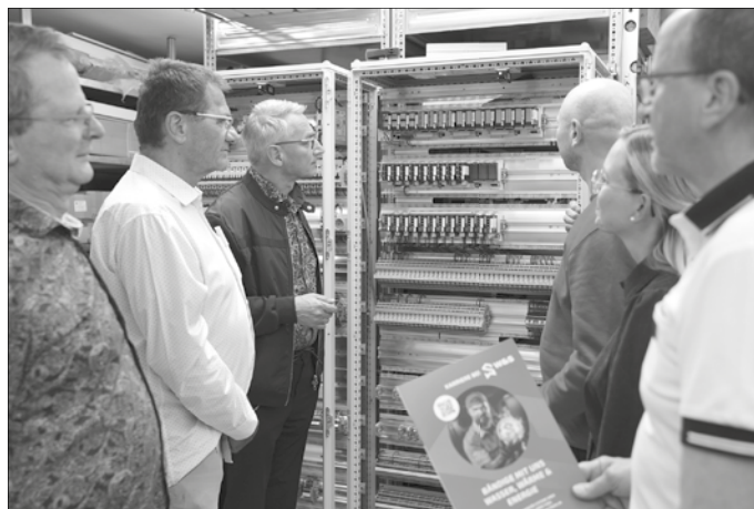
Der Angestellte Tilo Kulhavy (r. vorn) erklärt der Delegation einen im Aufbau befindlichen Schaltschrank am derzeitigen Produktionsstandort an der Chemnitzer Straße.
