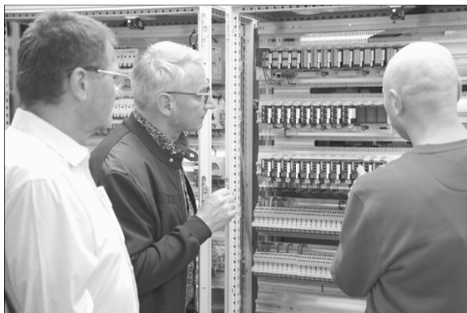
Der Angestellte Tilo Kulhavy (r.) erklärt Oberbürgermeister Volker Holuscha (Mitte) und W&S-Geschäftsführer Steffen Stier (l.) einen im Aufbau befindlichen Schaltschrank.
