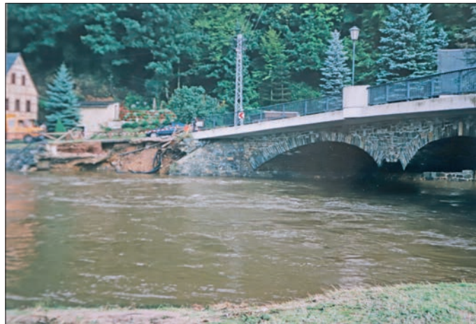
Deutlich zu erkennen – der zunächst unterspülte und danach durch die Flut abgerissenen Pfeiler der Schulbrücke.
