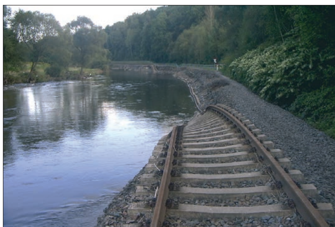
Flöhatalbahn – Richtung Falkenau zerstörtes Gleis
