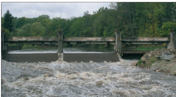
Das Wehr in einem sehr desolaten Zustand
