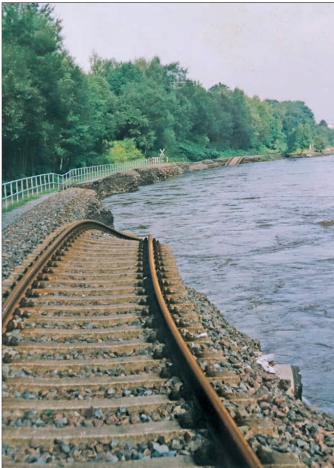
Der in die Fluten der Flöha gerissene Abschnitt der Flöhatalbahn zwischen Falkenau und Flöha – Blick aus Richtung Falkenau.
